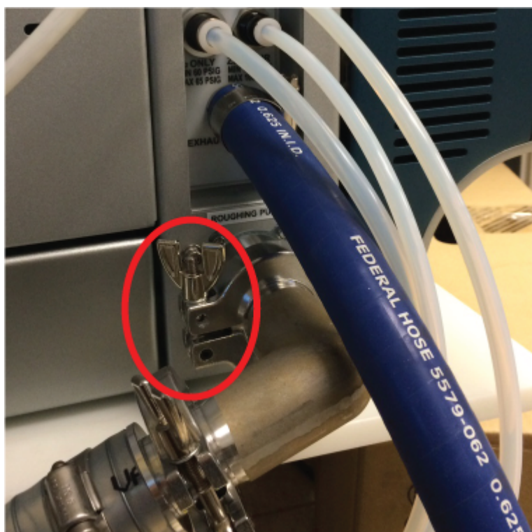
Figura 6-16: Morsetto correttamente installato
